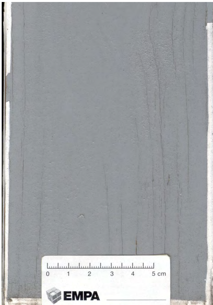
Bild 93: Starke Rissbildung in der Nanocoat-Beschichtung (Grundierung 5 mit Deckschicht 6) nach 12 Monaten Freibewitterung (Hauptversuch 3, Probe 8556.07.01)
