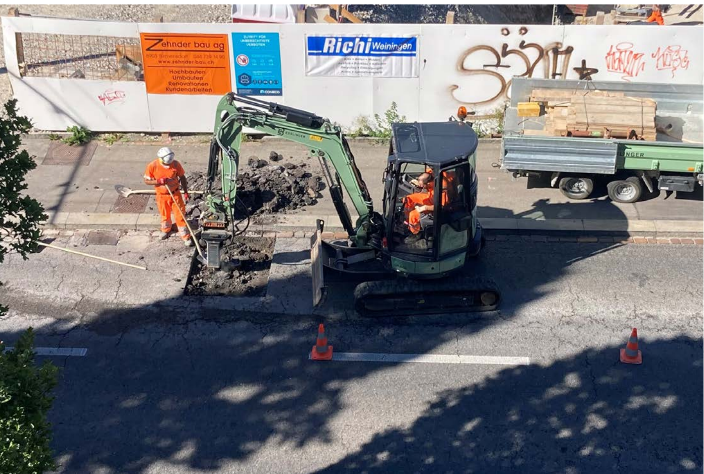
Im Gegensatz zu anderen Ländern kommen in der Schweiz noch kaum alternative Baustoffe im Strassenbau zum Einsatz. (Bild: Redaktion)
