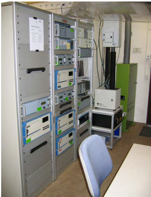
Abb. 2-46: Innenansicht einer NABEL-Station
