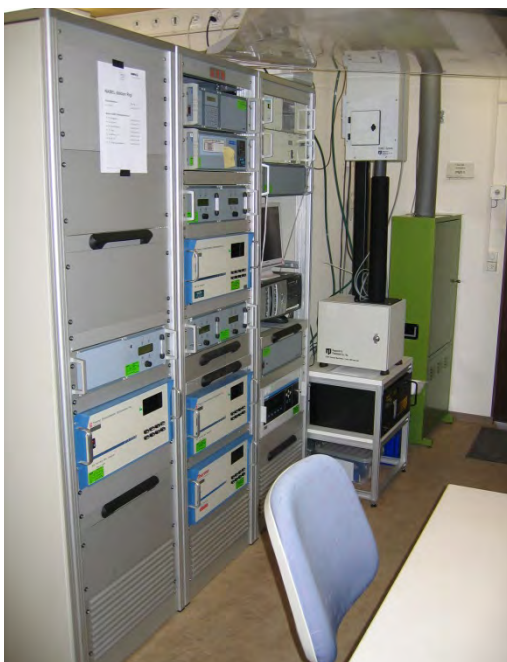
Abb. 2-46: Innenansicht einer NABEL-Station
