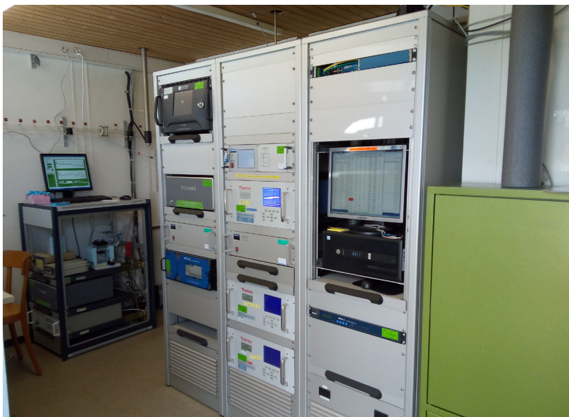
Abb. 2-48: Innenansicht einer NABEL-Station
